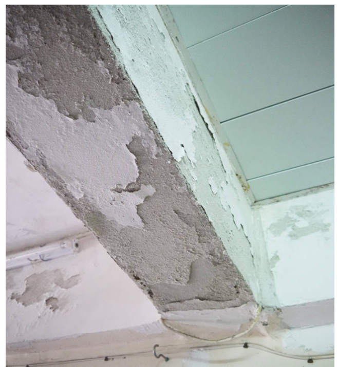
圖27：五街樓宇內住宅單位的天花剝落情況
