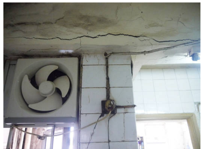
圖26：五街樓宇內住宅單位的牆身裂痕
