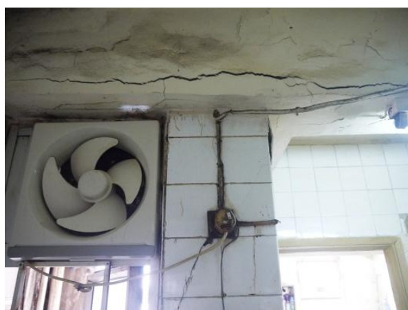
图26：五街楼宇内住宅单位的墙身裂痕
