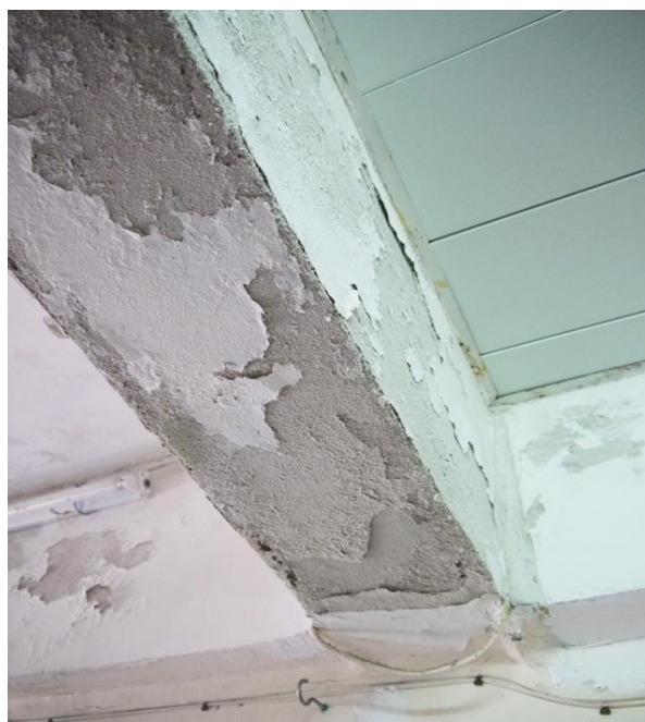
图27：五街楼宇内住宅单位的天花剥落情况
